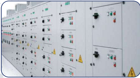
Hệ thống điện hạ tầng
